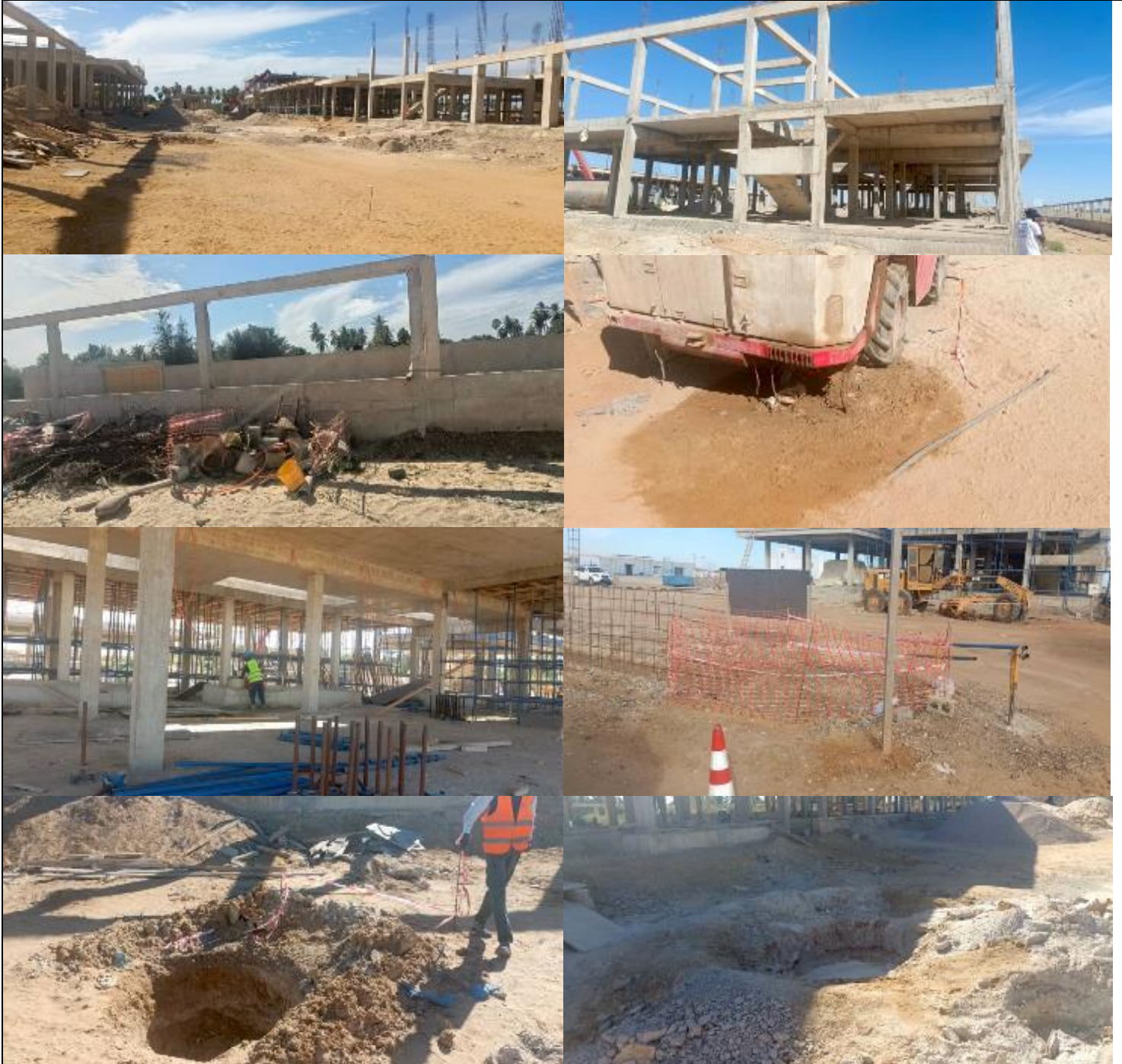
Photo 1 : Images illustratives du chantier du centre de formation aux métiers du pétrole et du gaz de Saint-Louis (20/01/2025)
