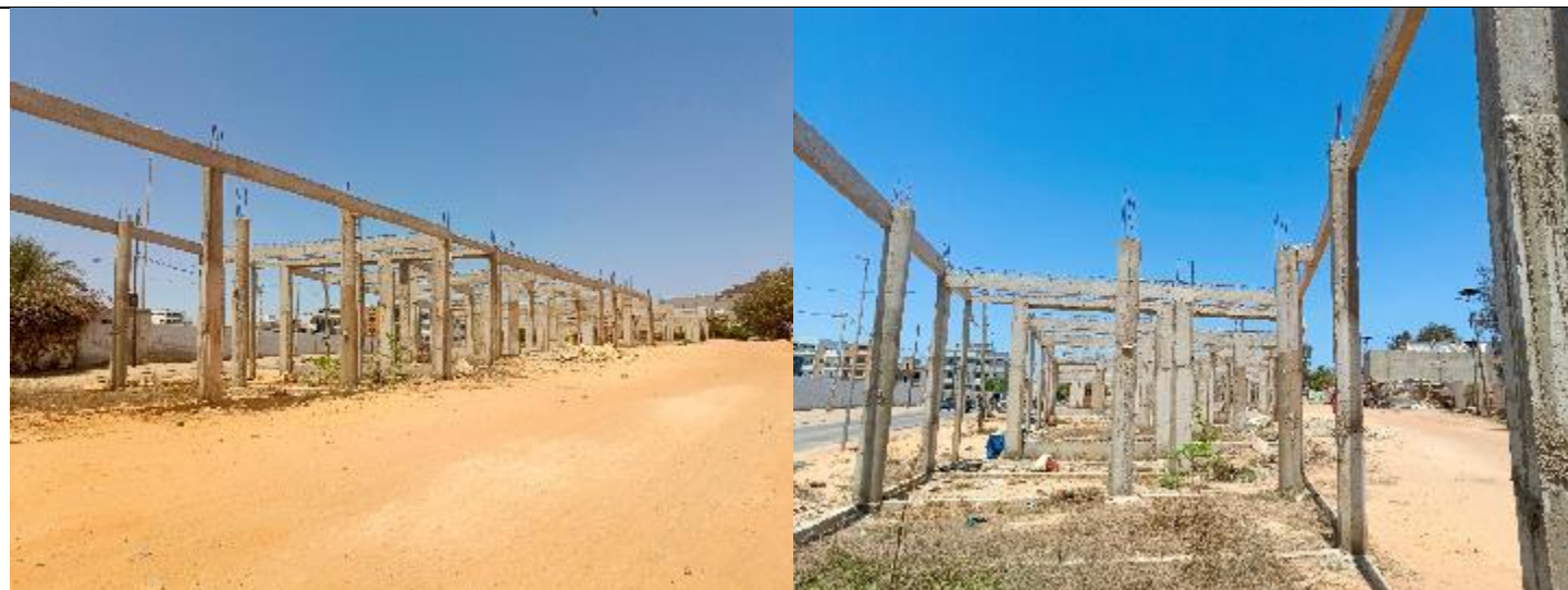
Photo 3 : Images illustratives du chantier du centre d'incubation de l'ITA (Travaux en arrêts) (16/05/2024)
