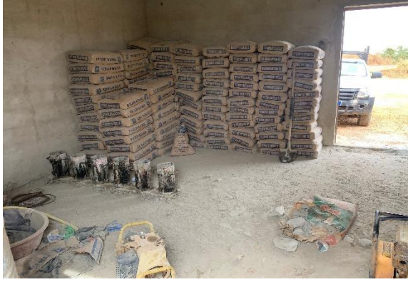
Photo 9 : Dépotoir de matériaux
